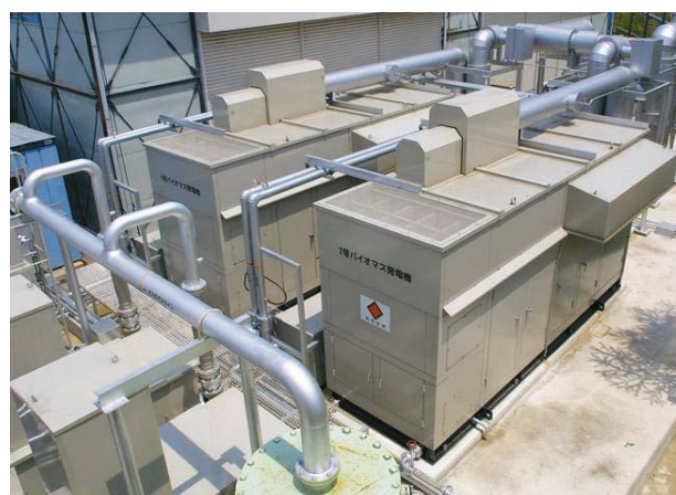
バイオ燃料エンジン発電システム
