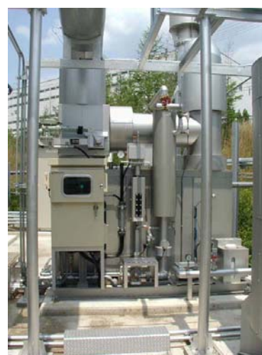
簡易ボイラ式排熱回収システム
