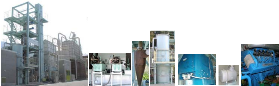
② 固定床ガス化炉 (全景) ① ブリケッター ③ サイクロン ④ スクラバー ⑤ セパティフィルター ⑥ バグフィルター ⑦ ガスエンジン発電機
